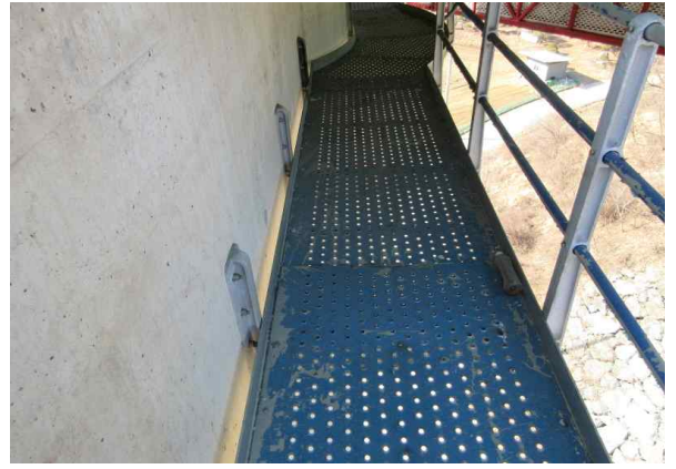
점검통로 설치현황 P2
