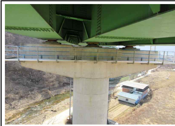
점검통로 설치현황 P2
