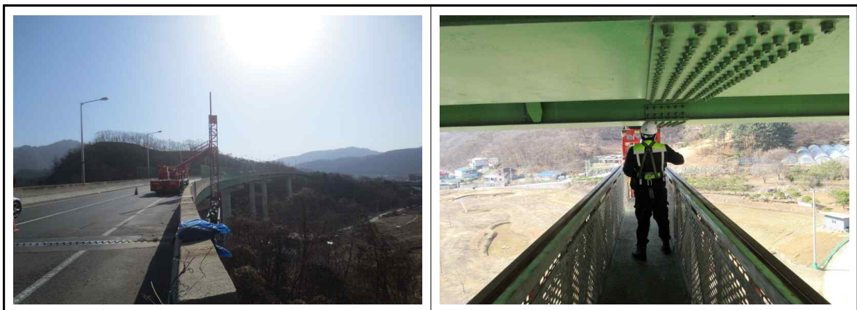
[그림 6.10] 금남IC Ramp-H교 현장조사 현황
