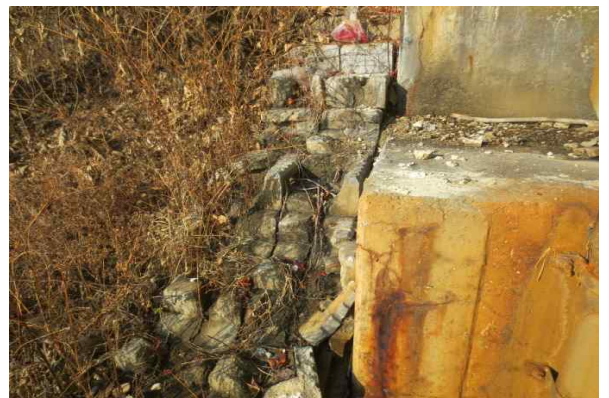
점검계단 파손 A1
